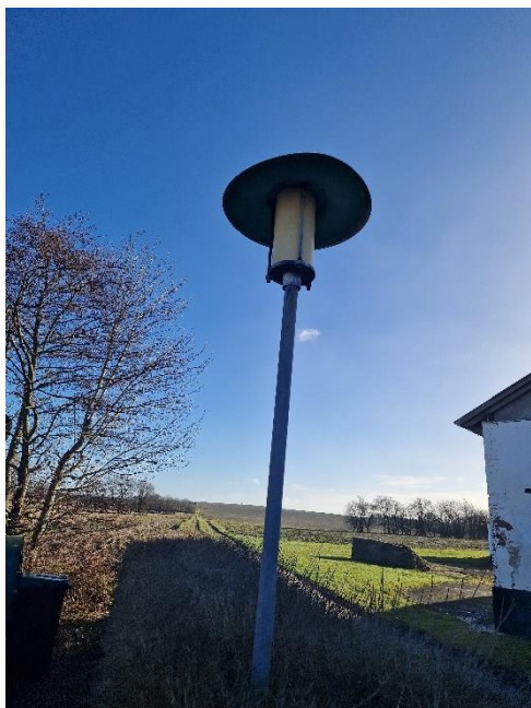
GL. gadelampe med glødepærer ønskes udskiftet til LED gadelamper
