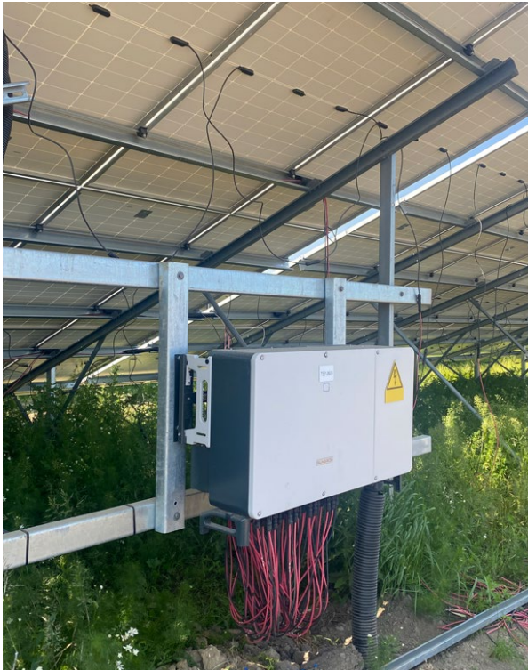
Eksempel på inverter, der er monteret på stativer under solcellepanelerne.
