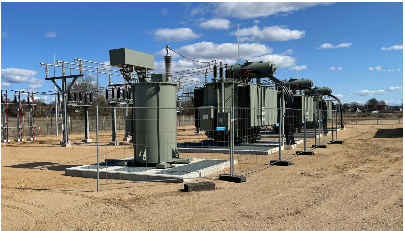
Eksempel på intern transformerstation (nettilslutningsanlæg) uden teknikbygning (NRGi Renewables).
