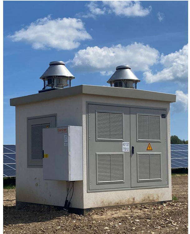
Eksempel på step-up transformer placeret langs en intern kørevej.
