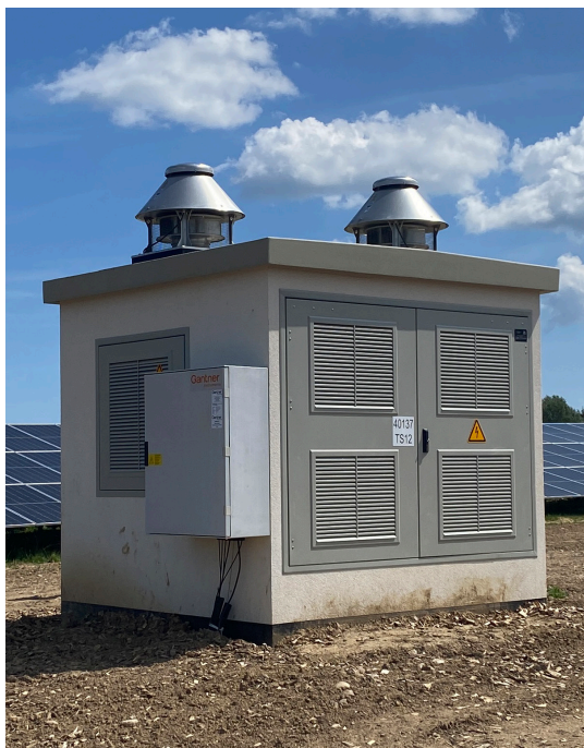
Eksempel på step-up transformer placeret langs en intern kørevej.
